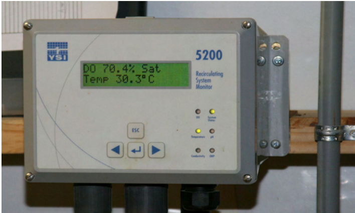
Uno de los veinte 5200 montados en la pared en el tanque de crecimiento.
